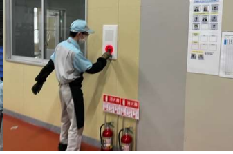
火災発生を聞いた近くの者は火災を確認し、火災報知機作動操作
